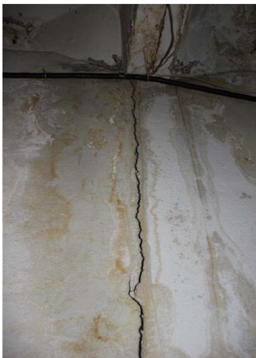
Рис. 4. Вертикальная трещина в поперечной стене по оси 4 на третьем этаже между осями Б и В . Ширина раскрытия 6 – 8 мм, начало от потолка
