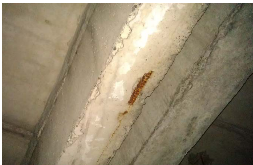
Рис. 5. Отслоение защитного слоя бетона в балке и плите перекрытия. Видна оголенная рабочая арматура
