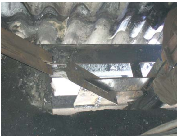
Рис. 1. Разрыв раскоса фермы пролетного строения
