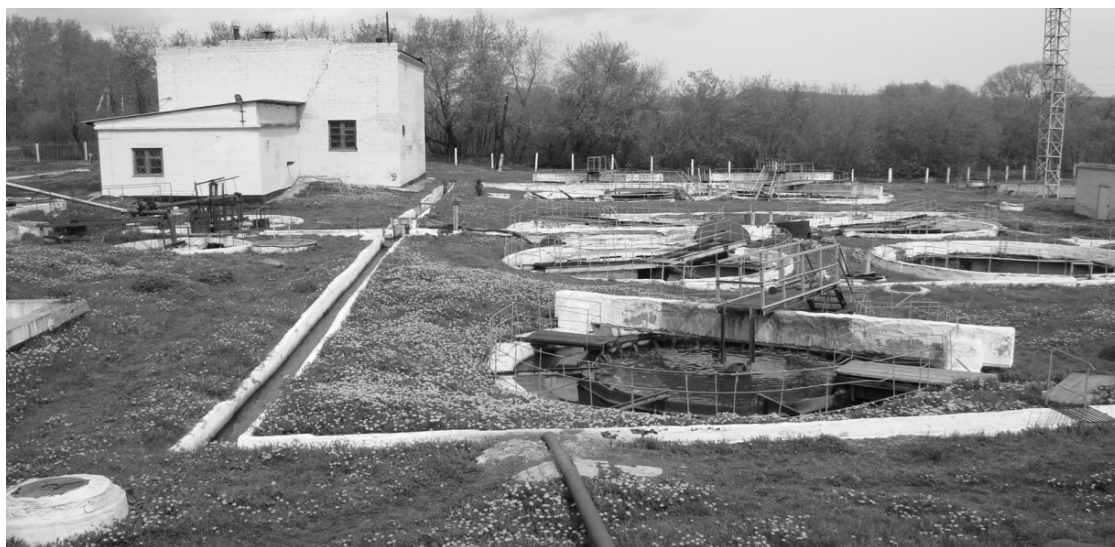
Рис. 1. Очистные сооружения 5-го канализационного бассейна
