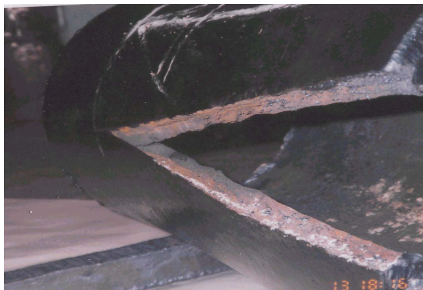
Рисунок 7 – Общий вид разрушенного паропровода
