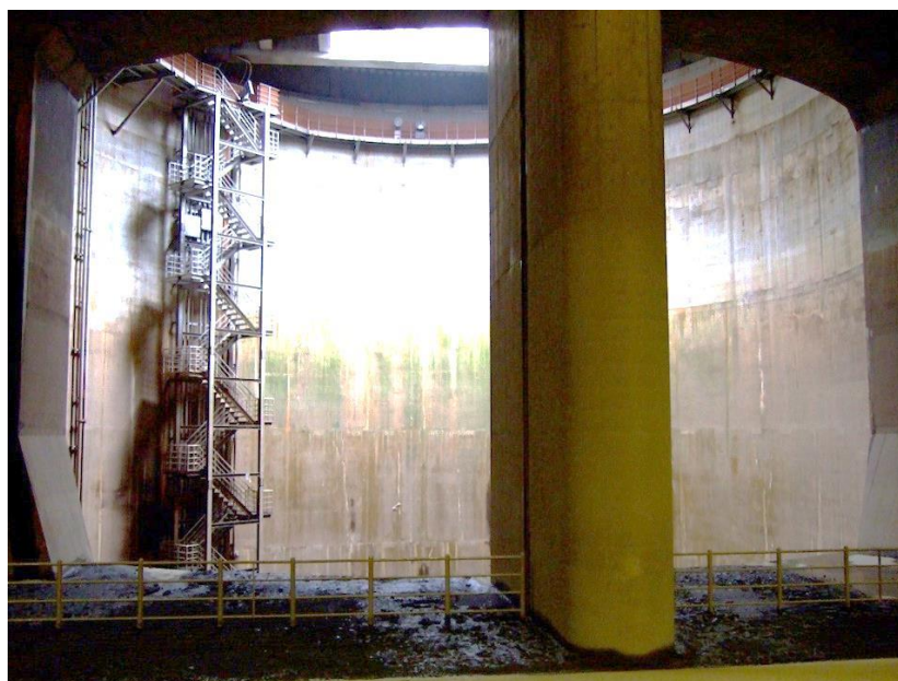
Рисунок 7 – Общий вид стакана-водосборника
