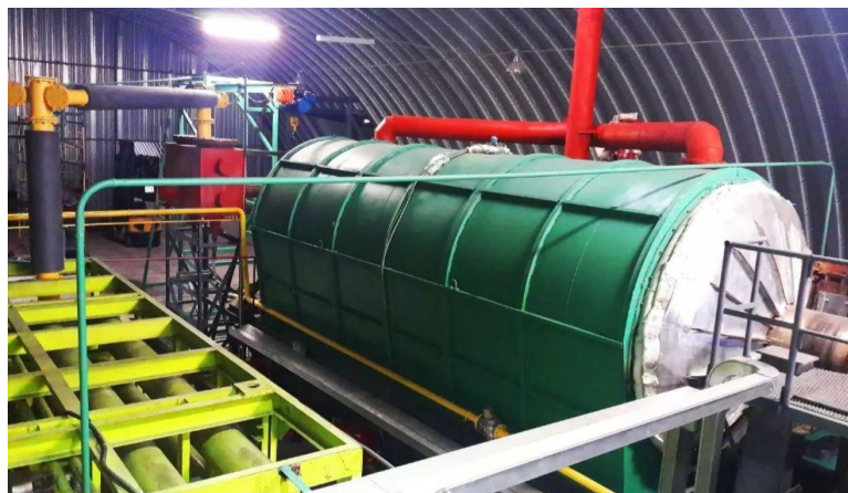
Рисунок 3 – Пиролизная установка по переработке отходов
