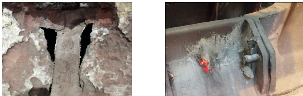
Рисунок 1 – Прогар секций вследствие высокотемпературной газовой коррозии [1]
