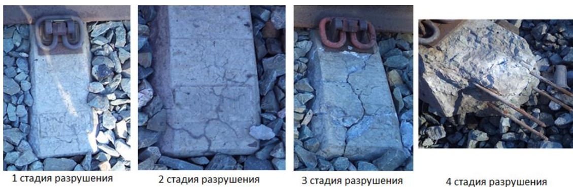
Рисунок – Стадии разрушения железобетонных шпал
