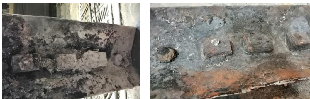
Рисунок 1 – Общий вид образцов на секции при демонтаже после эксплуатации
