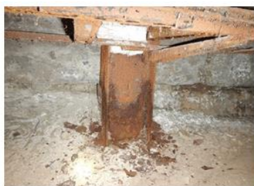
Коррозия металлических стоек на высоту до 400 мм от уровня пола м износом до 33%
