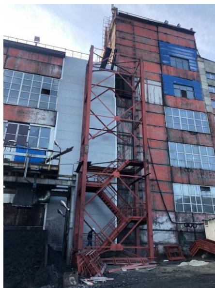
Рисунок 3 – Фасад по оси ряда А, оси 4-5. Выполненная замена стенового ограждения на сэндвич-панели
