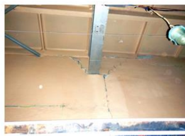
Трещины по шву в кирпичной кладке самонесущей стены с раскрытием до 10 мм, из-за отсутствия зазора между стеной и телом балки покрытия
