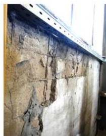
Разрушение с внутренней наружной стороны стеновой панели бетона на глубину до сквозного оголения арматуры
