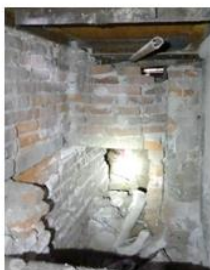
Разрушение подпорных столбов из кирпичной кладки, расслоение кирпича, рыхлый раствор
