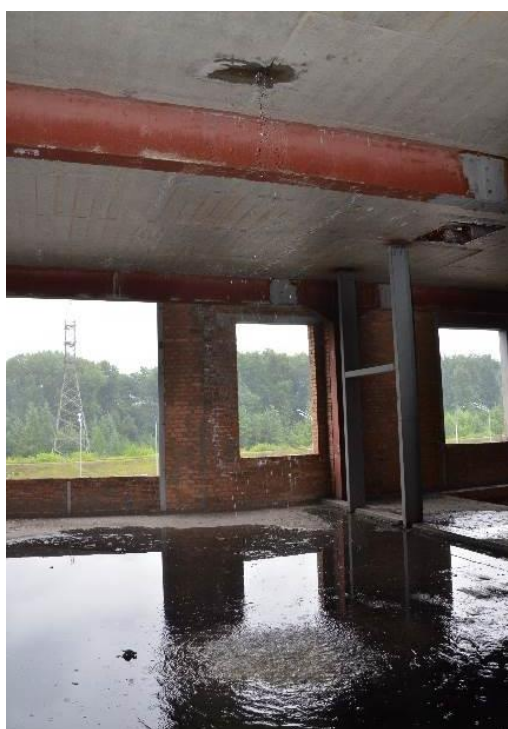
Рисунок 3 – Наличие влаги на перекрытиях
