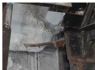
Разрушение бетона продольного (поперечного) ребра плиты в местах опирания с оголением арматуры
