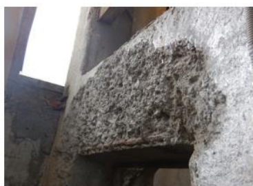
Разрушение защитного слоя бетона колонны на глубину до 100 мм с оголением рабочей арматуры
