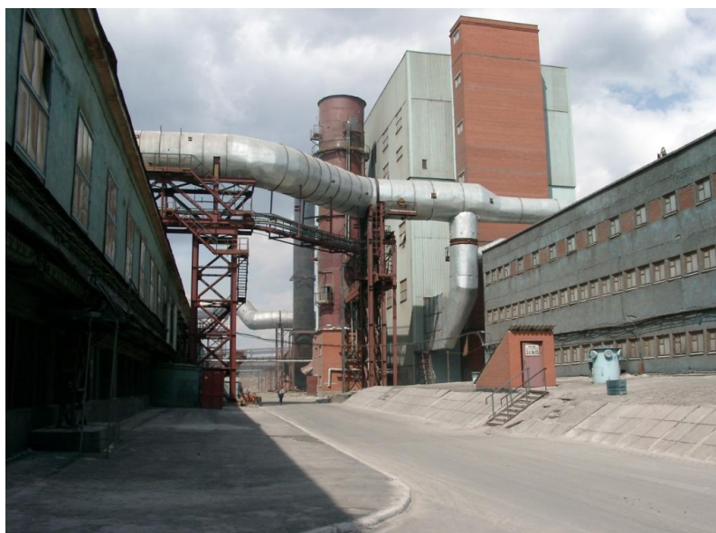
Рисунок 2 – “Сухая” газоочистная установка 6 – ой серии электролизного цеха БАЗа
