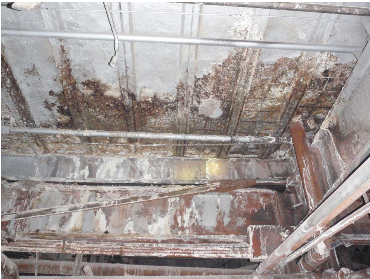
Рис. 2. Дефекты плит покрытия
