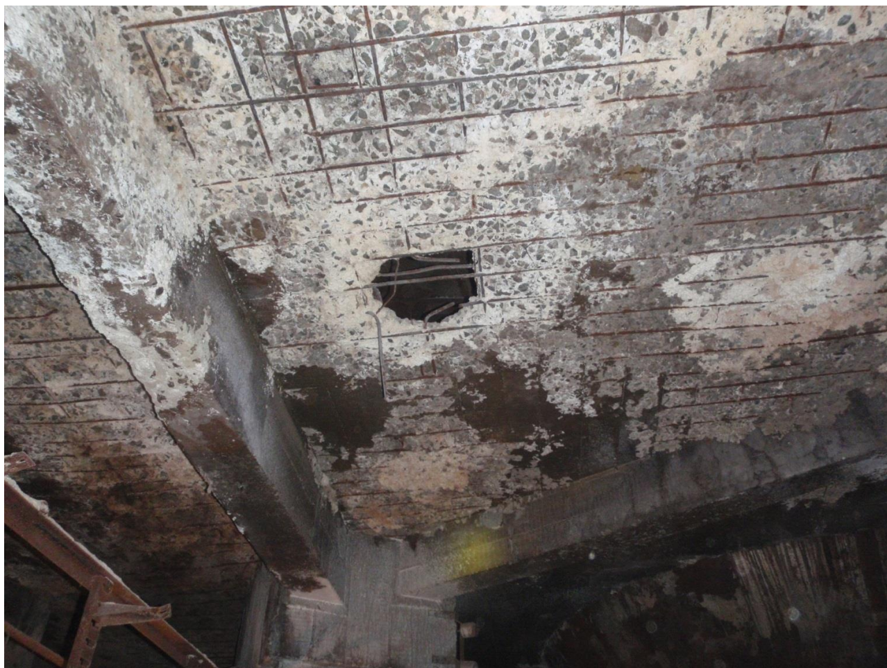
Рис. 1. Дефекты перекрытия на отметке +6,800 м
