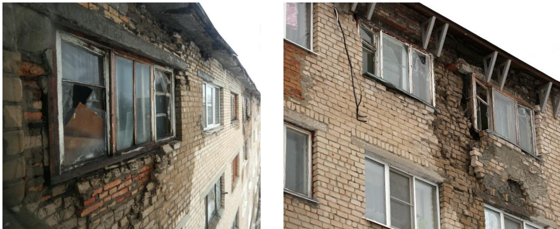
Рисунок 4 – Обрушение кладки стены дома
