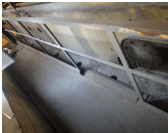
Рисунок 5 – Разрушение участка нижнего элемента ограждения
