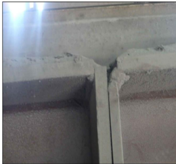
Рисунок 3 – Недопустимый сварочный зазор
