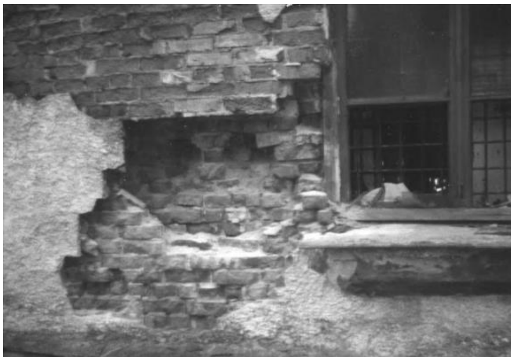
Рисунок 1 – Разрушение кирпичных стен здания от размораживания кладки
