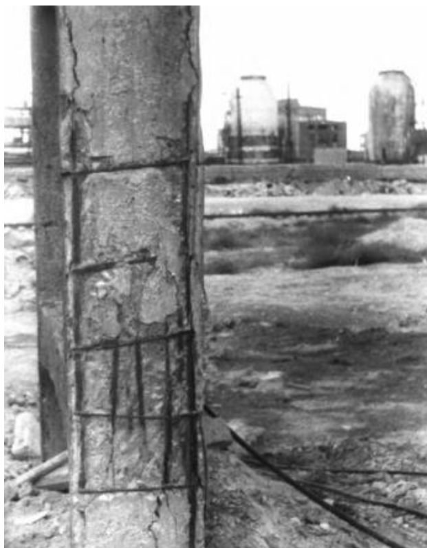
Рисунок 2 – Разрушение железобетонных колонн эстакады от коррозии арматуры
