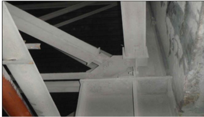
Рисунок 2 – Ослабление болтов крепления элемента горизонтальных связей и распорки по нижним поясам стропильных ферм покрытия
