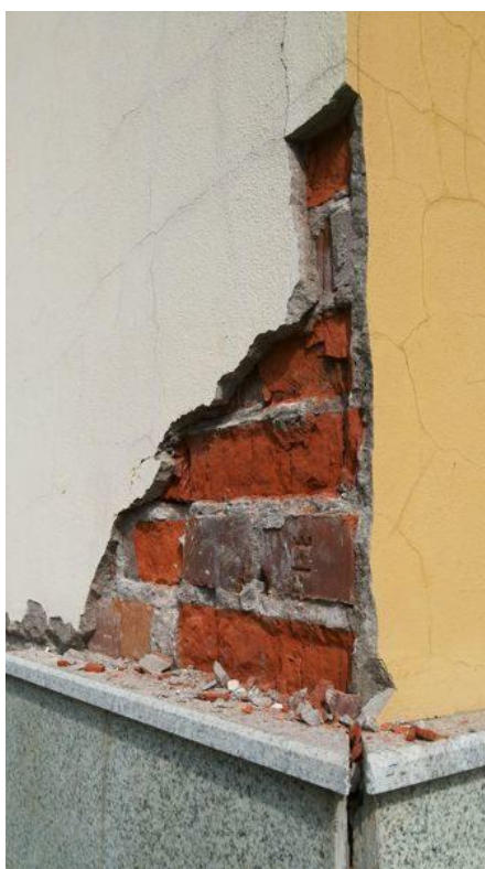
Рисунок 3 – Разрушение кирпичной кладки стены
