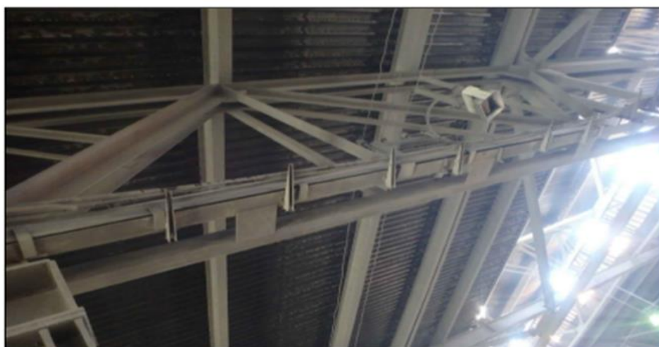
Рисунок 1 – Некачественное выполнение усиления в нижних поясах и раскосах стропильных ферм покрытия
