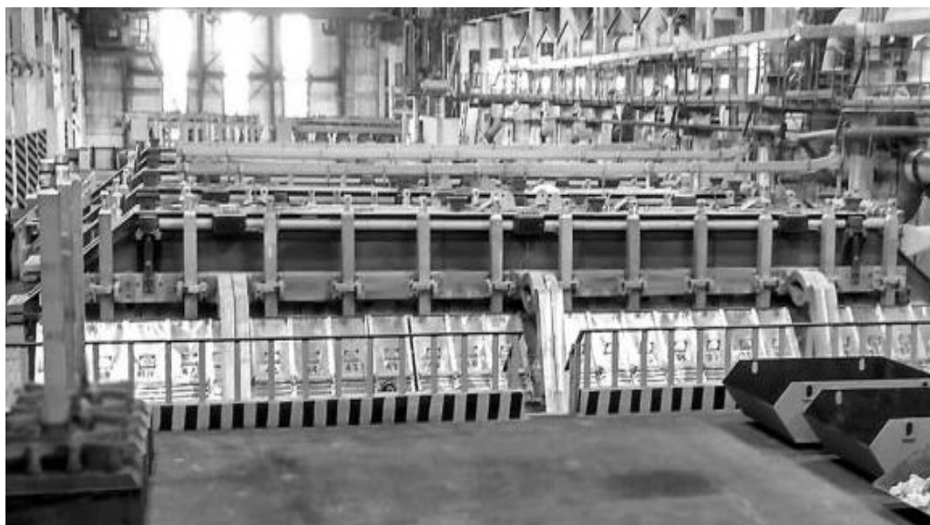
Рисунок 1 – Внешний вид электролизера на силу тока 550кА
