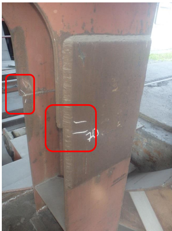
Фото 1 – Конструктивное несовершенство монтажного стыкового узла рамы вагоноопрокидывателя марки ВРС-125.
