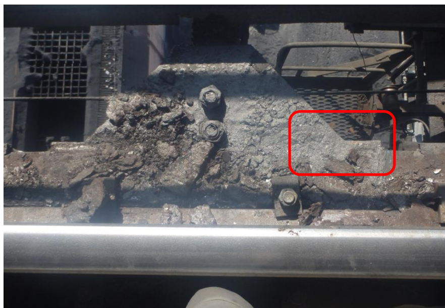
Фото 3 – Конструктивное несовершенство узла крепления фасонки к поясу ездовой балки крана-перегрузателя. Трещина в металле верхнего пояса ездовой балки
