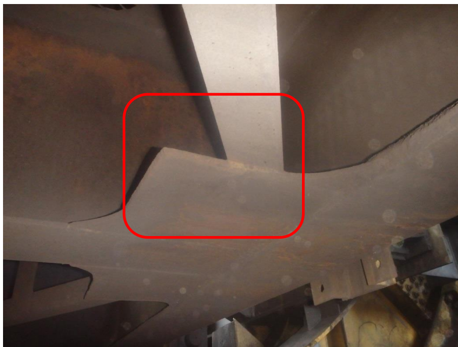
Фото 2 – Конструктивное несовершенство узла крепления элемента связи к фасонке. Разрушение элемента связи по всему сечению
