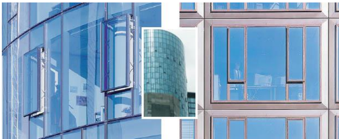
Рисунок 6 - Вариант наружных ограждающих конструкций здания «MAIN TOWER» - остекление стеклопакетами со створками, выдвигаемыми параллельно фасаду
