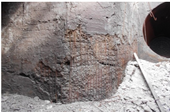
Рис. 2. Характер разрушения поверхности сооружения боровов дымовых труб
