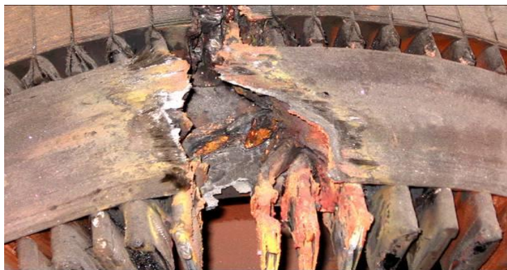
Рисунок 2 – Обрыв стержня асинхронного двигателя с «беличьей клеткой» от короткозамыкающего кольца вследствие термической перегрузки
