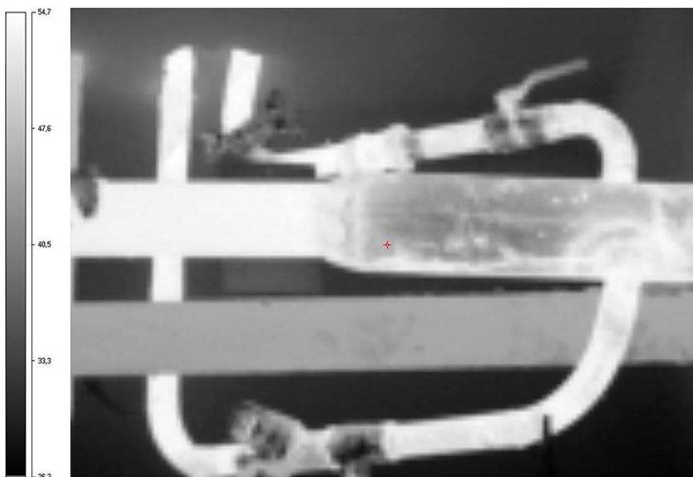
Рисунок 1 – Тепловизионная съемка труб систем отопления
