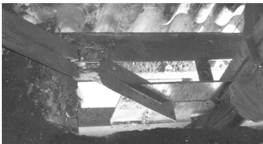
Рисунок 6 – Разрыв связи из-за коррозии
