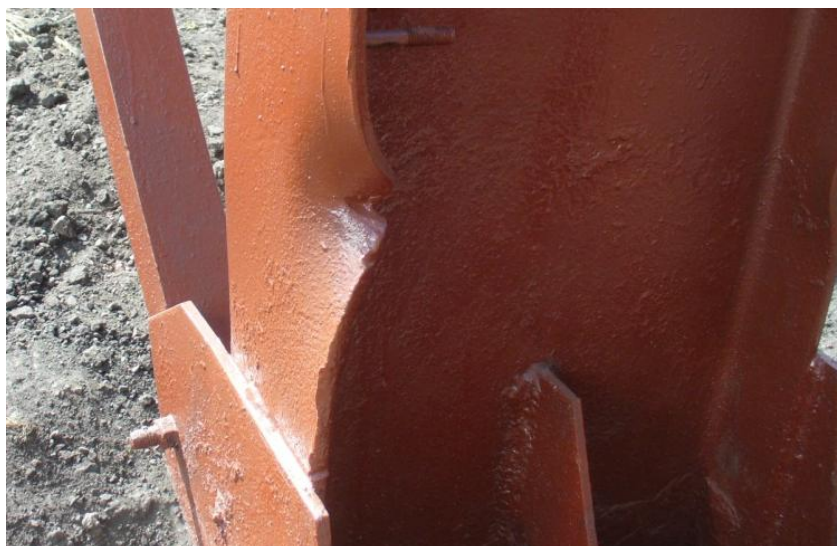
Рисунок 3 – Механические повреждения полки двутавра
