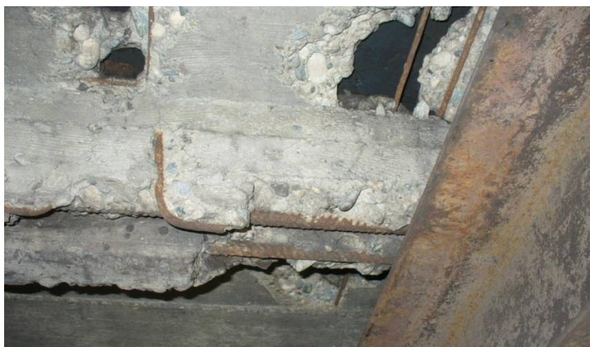
Рисунок 7 – Разрушение бетона ребер и полок плиты, коррозия арматуры
