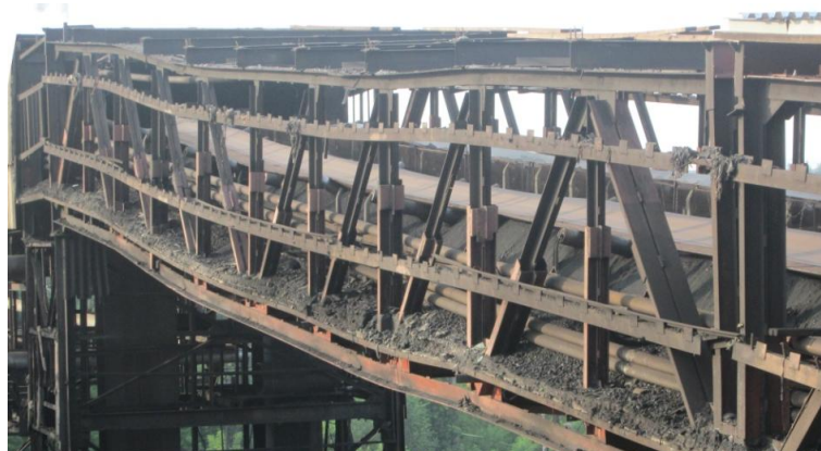
Рисунок 2 – Скопление просыпи угля на пролетном строении транспортерной галереи
