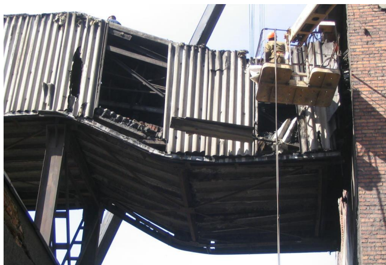
Рисунок 1 – Деформация консольной части галереи подачи угля
