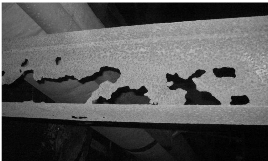
Рисунок 5 – Коррозия стальной балки
