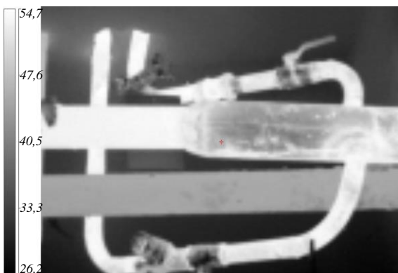
Рис. 1. Тепловизионная картина труб систем отопления
