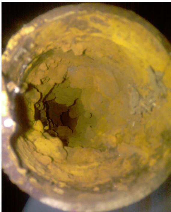
Рис. 2. Фрагмент стояка отопления с внутренними отложениями
