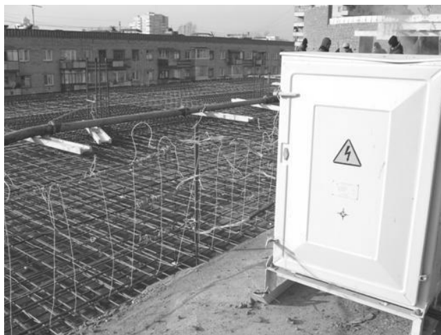
Рисунок 1 - Провод для прогрева бетона
