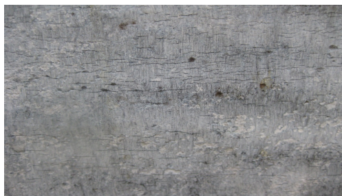
Рисунок 1 – Коррозионные и стресс–коррозионные трещины у нижней образующей (в пределах 5...7 часов условного циферблата) на внешней катоднозащищаемой поверхности магистрального газопровода
