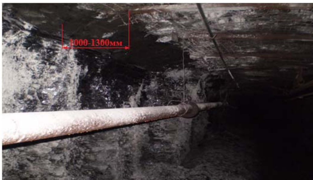
Рисунок 4 – Состояние участковой подготовительной выработки при нисходящем порядке отработки выемочных участков пласта Толмачевский (отслоение пород краевой части выработки со стороны охранного целика)
