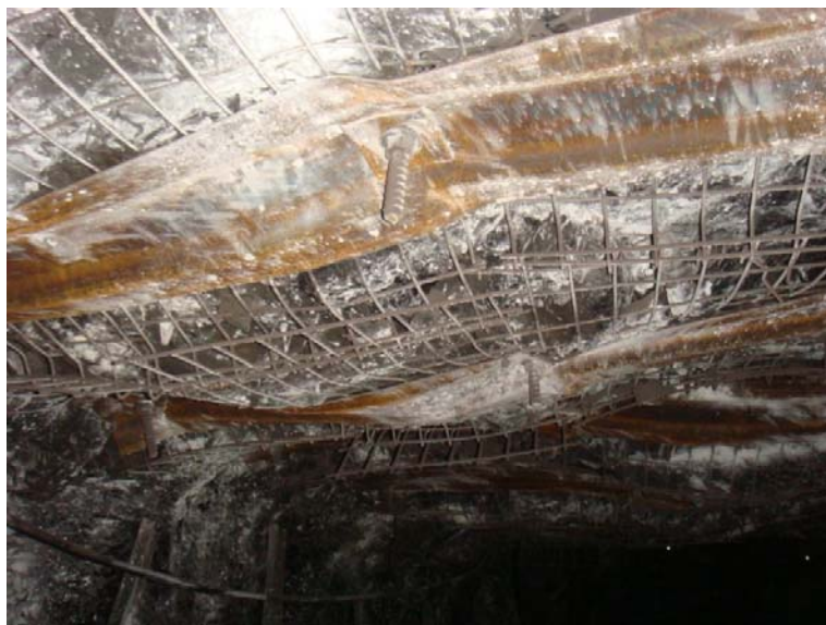
Рисунок 6 – Состояние конвейерного штрека 18-8, расположенного в зоне ПГД на 12.05.11 (замерный участок № 5)
