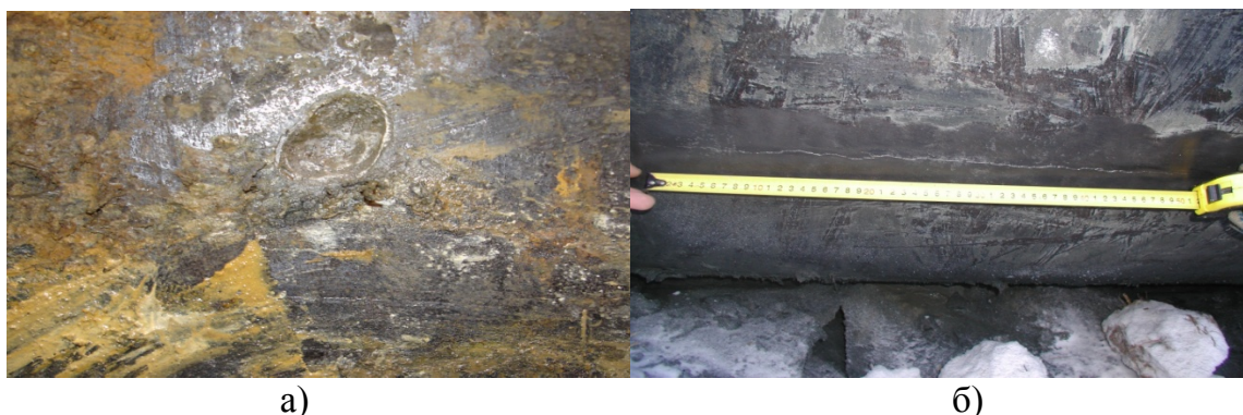
Рисунок 1 – Коррозионные язвы – а) коррозионные язвы и б) стресс-коррозионные трещины на внешней КЗП трубопровода после 32-х лет эксплуатации
