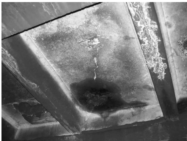
Рисунок 2 – Трещины в плитной части плит перекрытия
