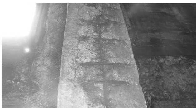
Рисунок 3 – Трещины в плитной части плит перекрытия
