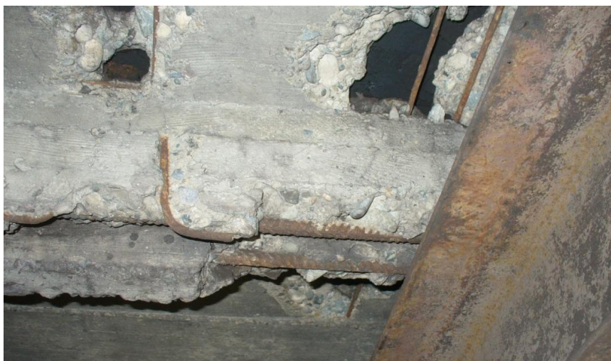
Рисунок 2 – Разрушение бетона ребер, полук
