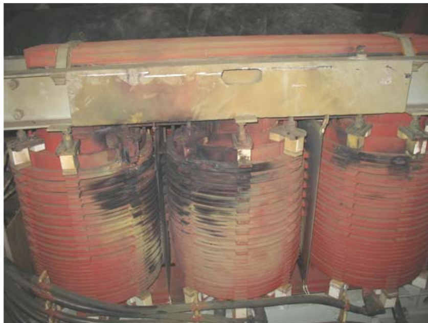
Рисунок 2 – Фотография поврежденного воздушного трансформатора
