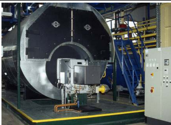
Рисунок 7 - Котельная установка, работающая на метане
