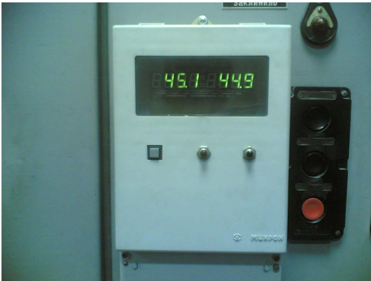
Рисунок 3 - Внешний вид контроллера 2-го подъема ЛЦВС.
