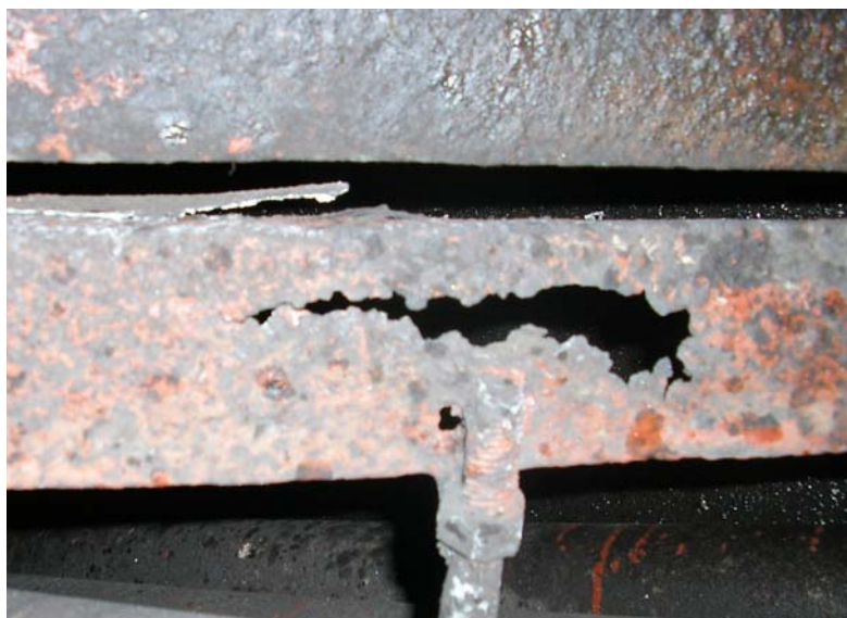
Рисунок 3 - Сквозная местная коррозия раскоса крестовой связи, расположенного под отверстием в перекрытии
